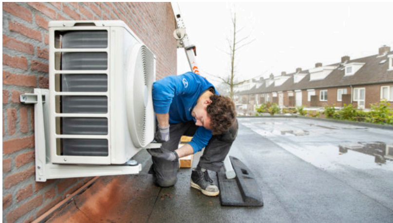
Een hybride warmtepomp heeft ook een buitenunit
